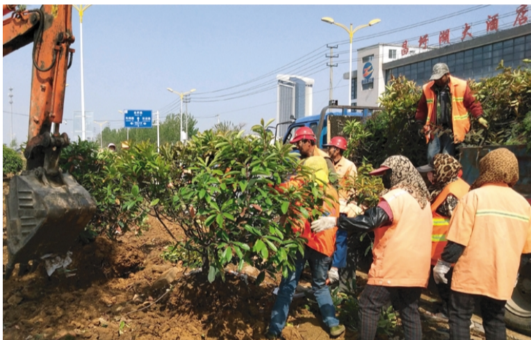
近期,开发区计划对昌圩路进行改造升级,应工程需求,4月15日上午,华茂公司积极组织人员、机械对昌圩路绿化带进行全面移植,移出的苗木除小部分留以改造新光路、神泉路等道路绿化景观外,其余大部分移栽到江宁工业园,为推进我市创建国家森林城市添砖加瓦。 (王 曜)
